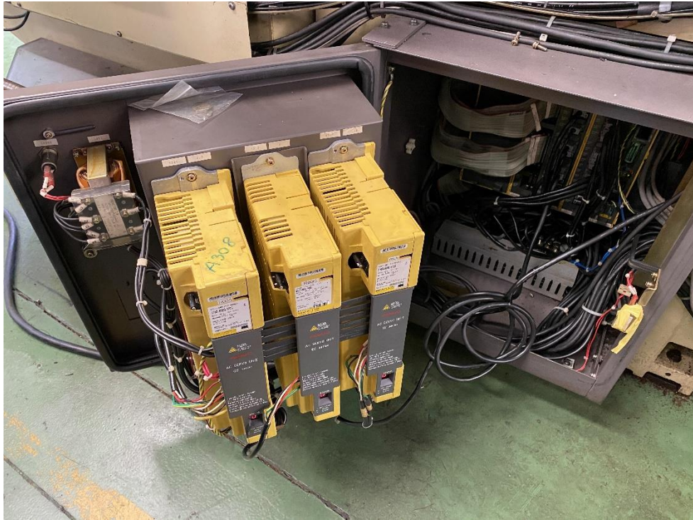
ภาพ ข-2 ตรวจสอบชุดอุปกรณ์ไฟฟ้า
